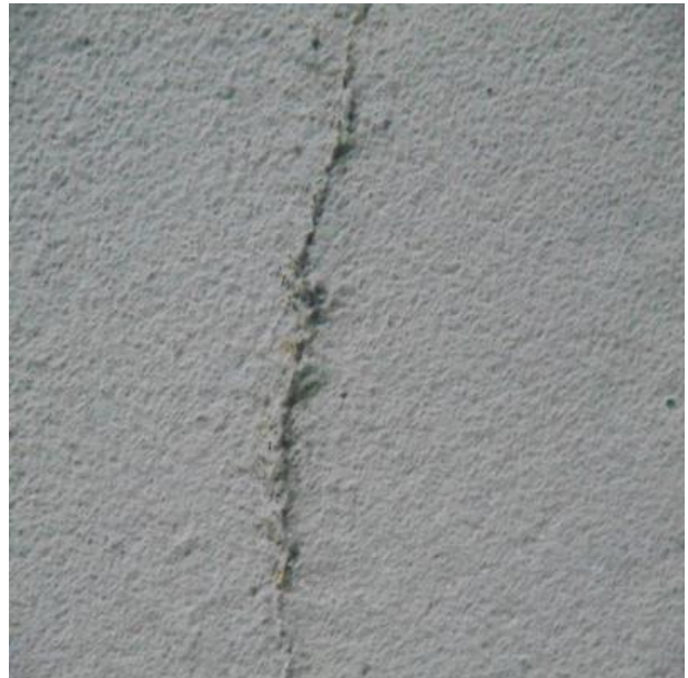
(d) Cracking- Image "D"
